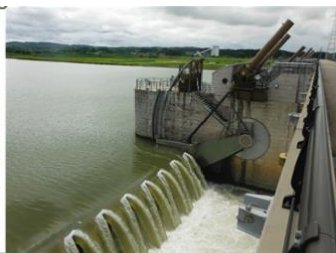
写真-3 可動堰のローラーゲート 3)
