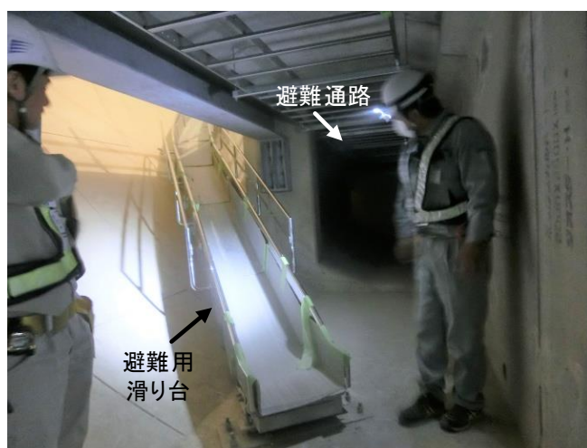
写真 3 トンネル内のすべり台および避難通路
