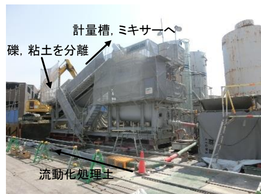
写真2 流動化処理土製造プラント
