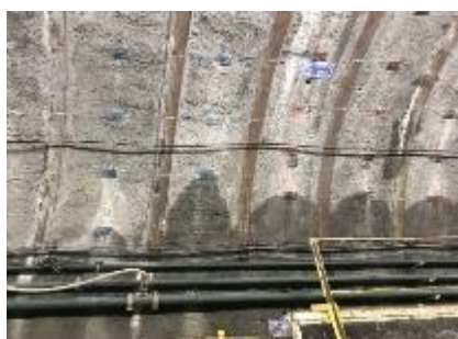
写真5 ロックボルト
