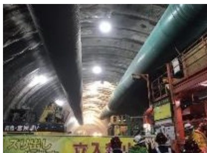
写真2 集塵機と送風機
