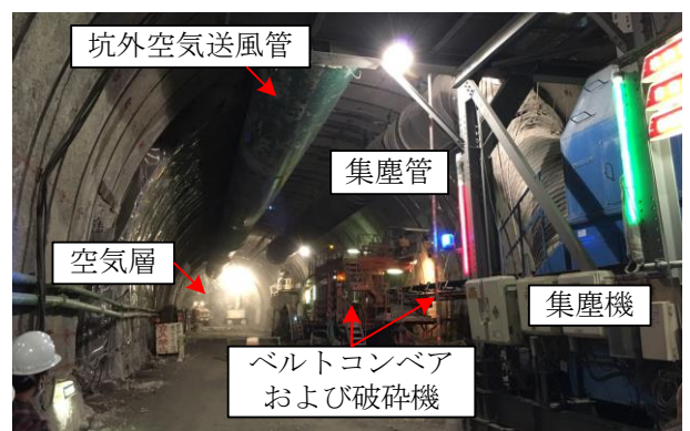
写真 2 換気設備ならびにずり搬出設備
