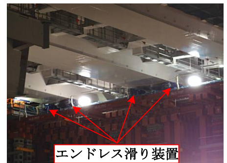
写真4 エンドレス滑り装置
